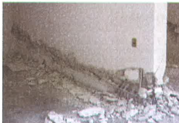
Figura 1. Necesidad de elementos de borde (ACI318-19) frente a daños producidos en muros a consecuencia del terremoto de maule (Cerde, 2011)
