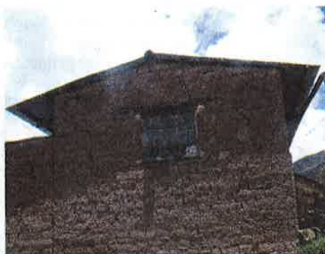
Foto N°10: Ventana ubicada en el tímpano, debilitando de ese modo al muro.
