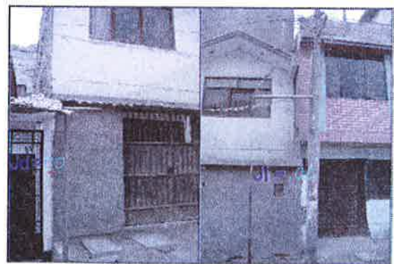
Fig. 11: Falta de junta sísmica - vivienda N°2 - Monterrey "A".
