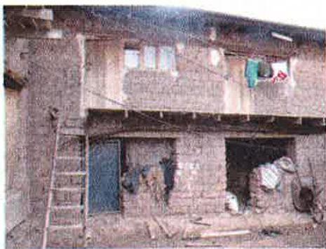
Foto N°9: Vivienda de adobe con aberturas grandes, donde las ventanas y puertas van continuas.
