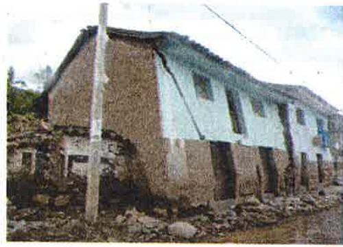
Foto N°7: Vivienda de adobe a punto de colapsar, por falta de protección del muro en la margen izquierda
