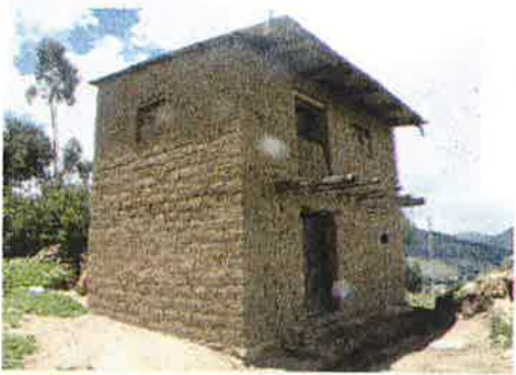
Foto N°6: Vivienda de adobe con poco sobrecimiento, cuya base del muro se encuentra expuesto al desgaste por parte de las lluvias.
