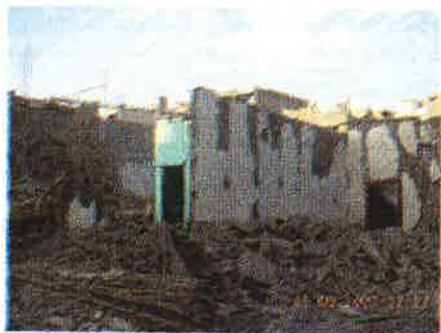
Foto N°1: Vivienda de adobe colapsada en Chincha (Terremoto de Pisco 2007)
