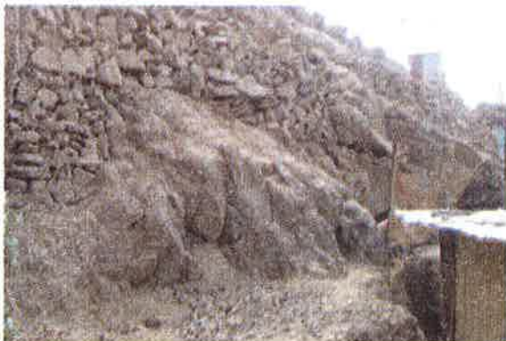
Fig. 3. Suelo rocoso que dificulta la excavación para la cimentación típica.
