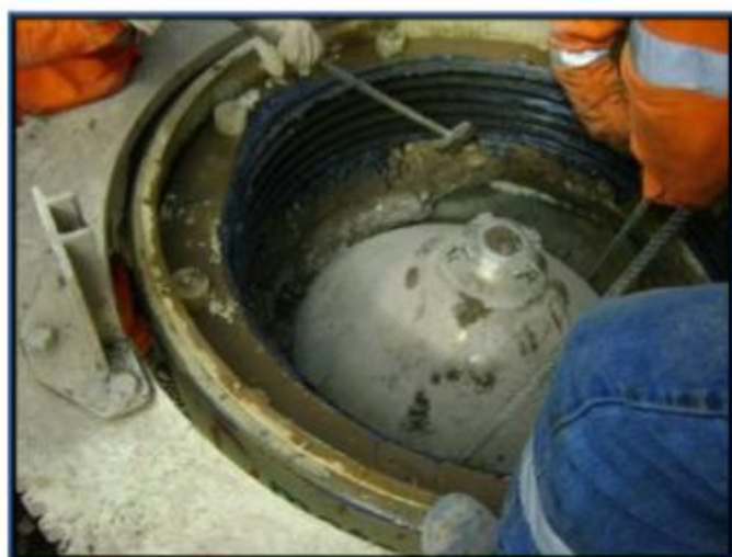
Fig. 10. Material barroso incrustado que infiltra sus aguas al sistema de lubricación producto de la falta de lavado
