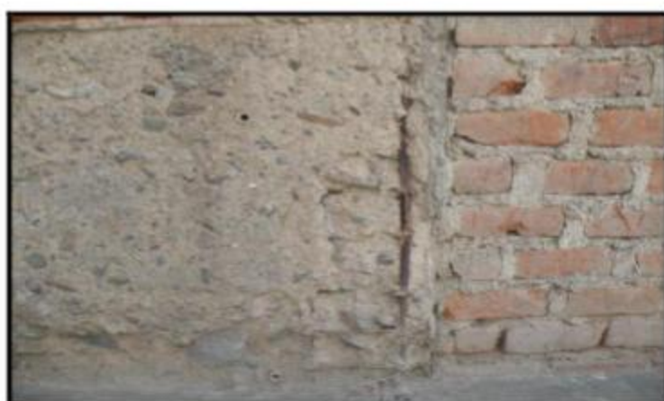
Foto #1: Se observa la parte inferior de una de las columnas de las viviendas seleccionadas, donde el concreto ha sido dañado por acción de las sales y ello ha hecho que este llegue hasta el acero de refuerzo (Vivienda #4).
