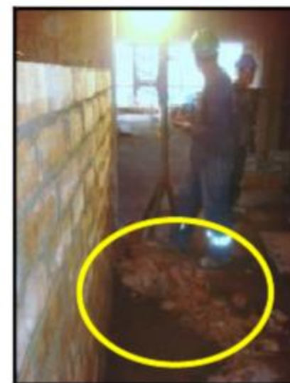
Foto 1. Desperdicio generado en obra, antes de tomar las medidas pertinentes (5).
