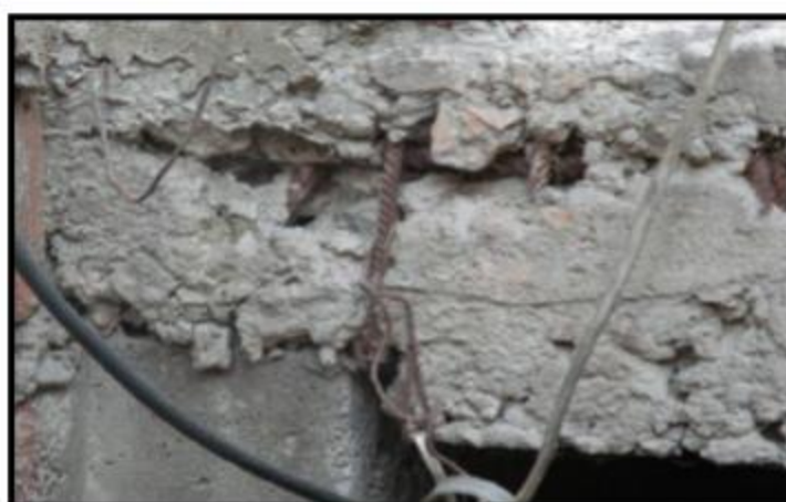
Foto #2: Se observa como el acero quedó expuesto a la intemperie (Vivienda #5)
