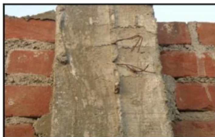
Foto #3: Se observa la columna agrietada por falta de curado, esto lo podemos ver por lo general en la parte más alta de las columnas, debido a que es en esta parte donde se pierde mayor agua, por el efecto de la gravedad.
